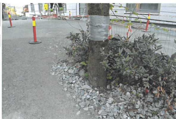
Skade på tre i forbindelse med byggearbeid. Denne måten å reparere skaden på er effektiv.
